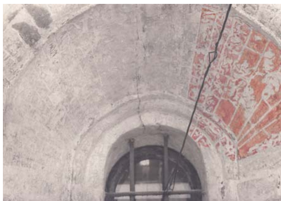
Архангельский собор. Северный фасад. Нижний ярус окон. Арка среднего оконного откоса с красной покраской по штукатурке и графленным (вырезанным) искусственным швом разделки под кирпич. Зондаж № 23 (3). Фотография с расцветкой гуашью В. Робинова, 1967 г.
